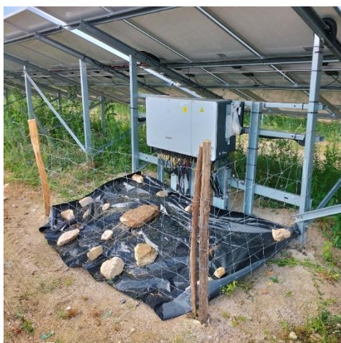
Figure ou Photo 1 : Exemple de protection mise en place autour d'un onduleur (Source : TotalEnergies)
